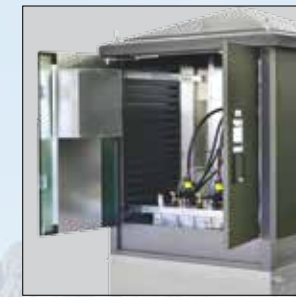
AMS-SKAP Plassert i dør inn mot trafo.
